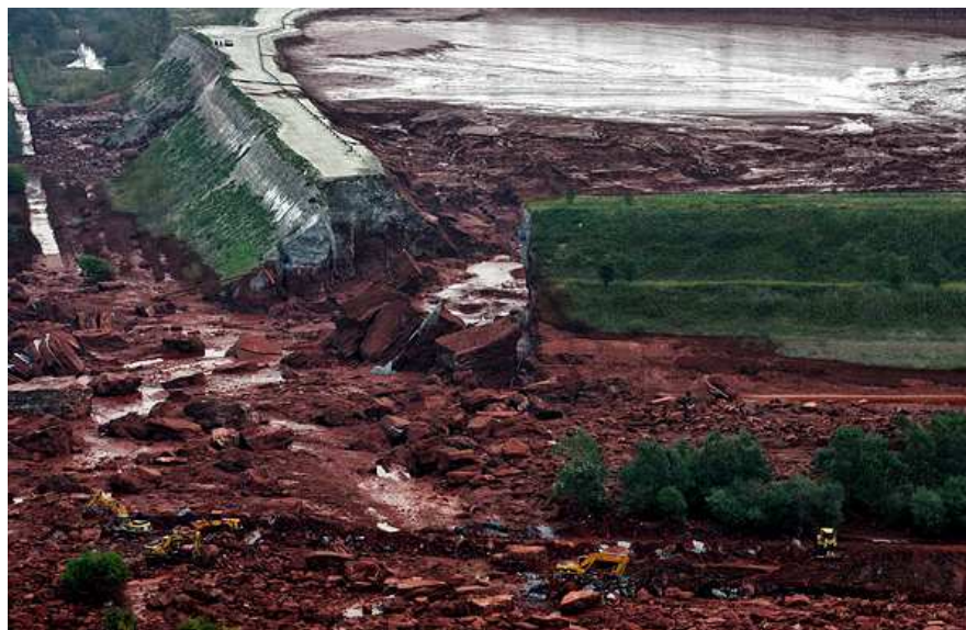
Рис. 2. Прорыв насыпной грунтовой дамбы шламохранилища в Колонтаре (Венгрия) (по [5]) Fig. 2. Break of bulk earth dam of sludge in Kolontár (Hungary)
